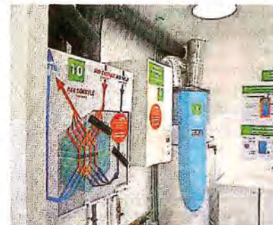
Le visiteur comprend comment fonctionne une pompe à chaleur : sur un tableau, il pourra suivre en temps réel la production d'énergie des 12 m 2 de panneaux photovoltaïques.
